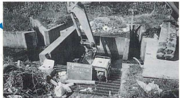
西Ⅱ号幹線 中野2号分水口の来雑物（フラワーセンター北門）
