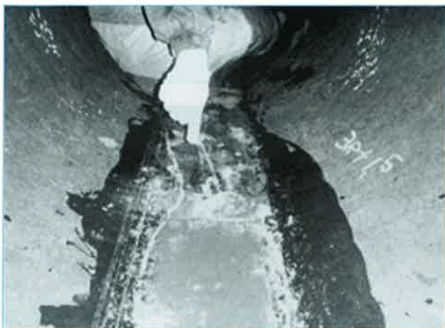
管の変形①(FRPMφ800)
