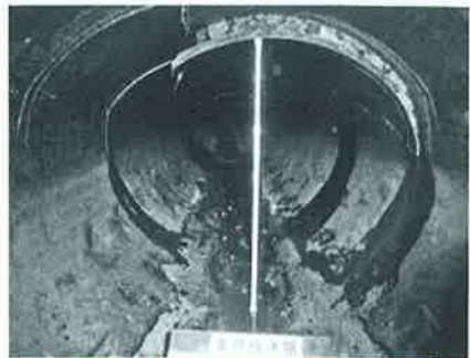
管内のたわみの状況
