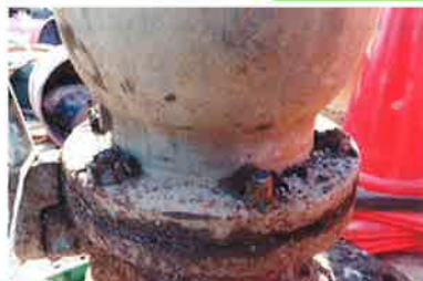
空気弁の経年劣化
