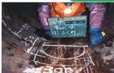
管底部 膨れ 状況 250mm(管軸) × 300mm(横) × 5mm(高さ)
