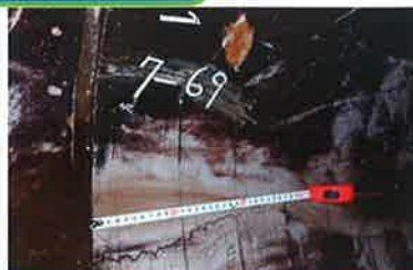
管底部ひび割れ 2mm(幅) × 270mm(長さ)
