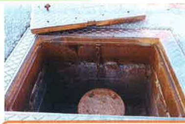
空気弁保護工の劣化
