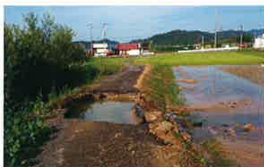
漏水事故による農道の陥没
