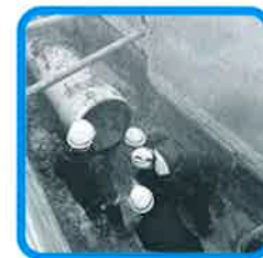
FRPM φ800～700の管内劣化原因を調査
