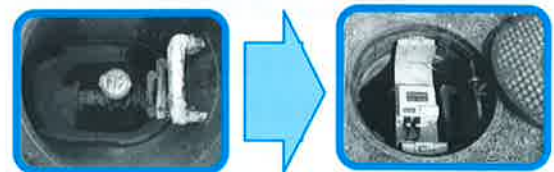
作動不良の流量計を超音波式流量計へ変更
