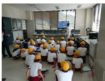
糶屋ダム管理所2階操作室
