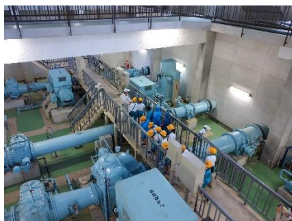
杉原川揚水機場
