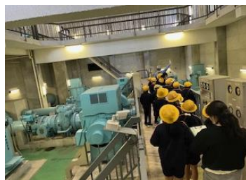
杉原川揚水機場
